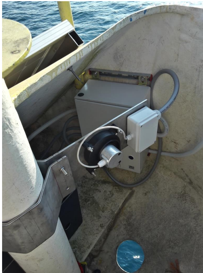
Figura 4.16 Nella foto sono visibili l'estensimetro ed il quadro di controllo con scatola di derivazione
