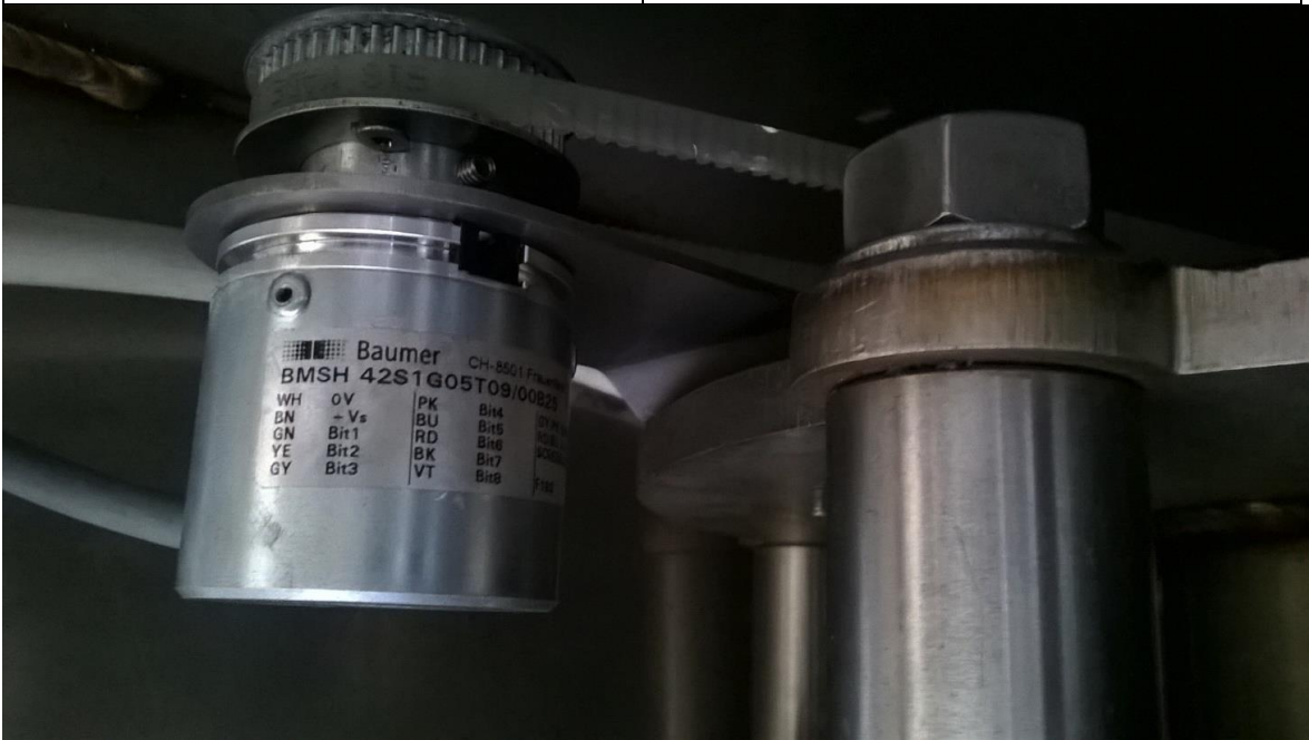
Figura 4.11 Encoder rotativo nel sito di installazione
