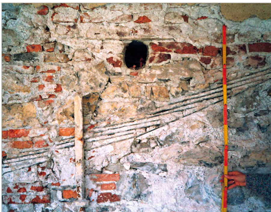
5. Resti di manto in abbadini inglobato nella muratura a seguito di una soprelevazione. La sovrapposizione delle lastre è in molti punti quadruplica, senza considerare il primo filare posato lungo la cresta muraria (ex monastero di Santa Maria delle Grazie la Nuova).
