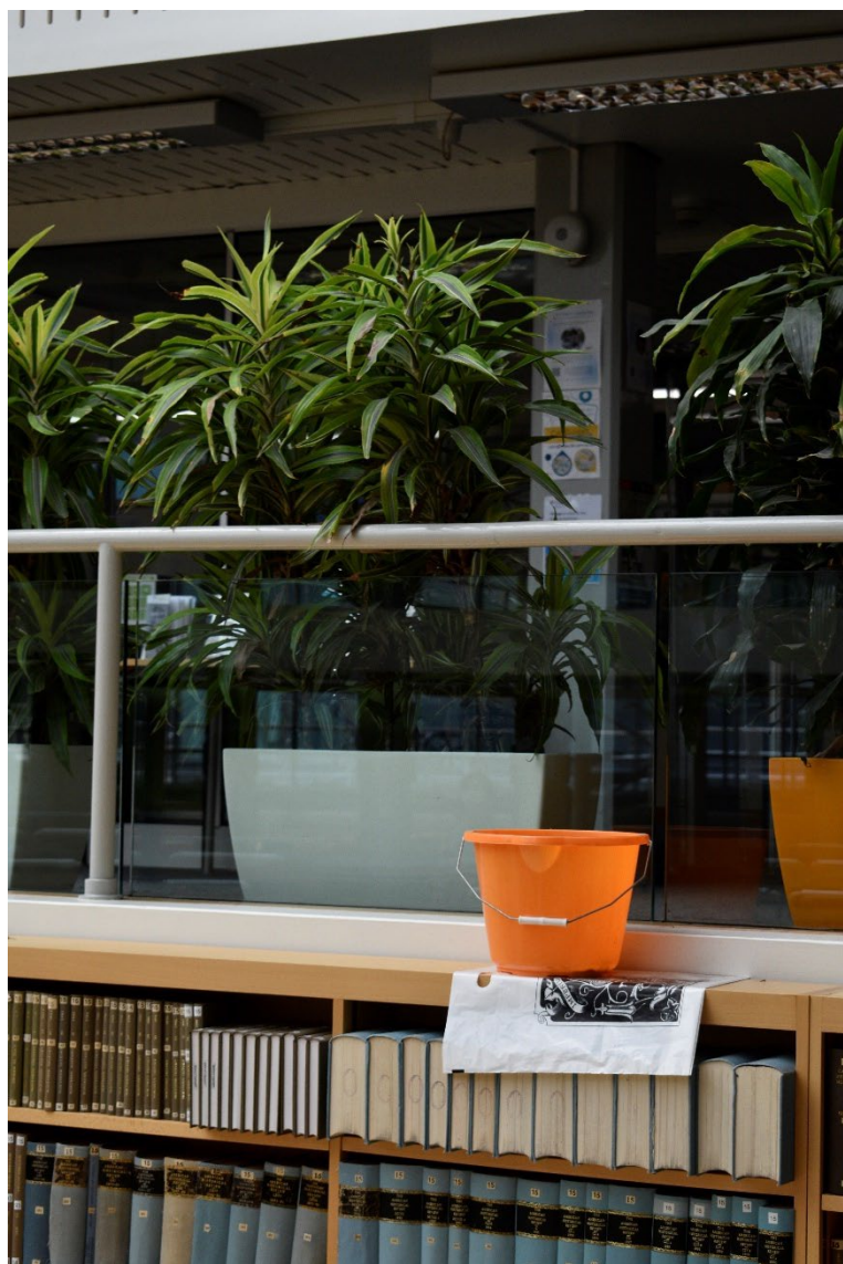
Fig. 50. History Faculty Library, University of Cambridge. Dettaglio della sala di lettura con recipiente provvisorio per la raccolta di infiltrazioni dalla copertura.
