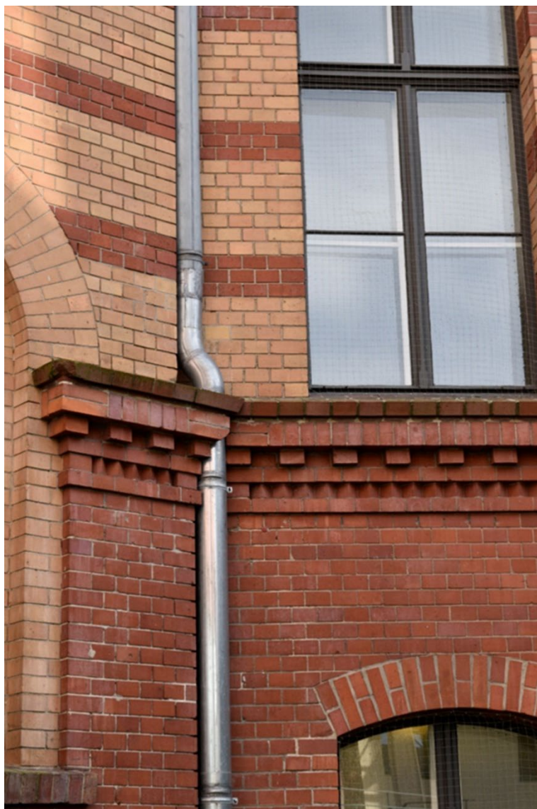
Fig. 129. Attacco della grondaia sulla facciata storica, con variazioni cromatiche dei laterizi.
