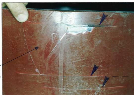
Fig. 4.66 Vista della superficie esterna di una bobina in resina epossidica. In questo caso si è in presenza di un distacco di materiale
