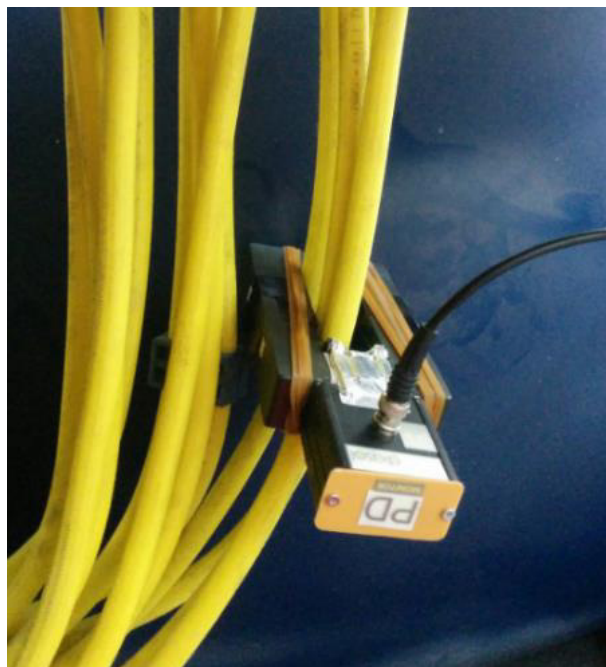
Fig. 6.7 HFCT posizionato dietro T1 e sotto C.
