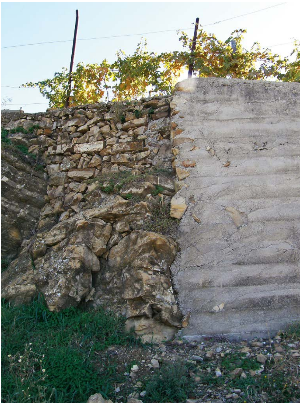
Foto 7. Roccia, pietre a secco e... uso improprio del cemento (foto G. Ghiglione).
