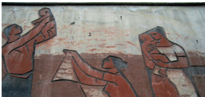
Fig. 131 - Particolare dei fenomeni di degrado del graffito di Janos Blaski: interruzioni di continuità del graffito dovute alla presenza di fessurazioni
