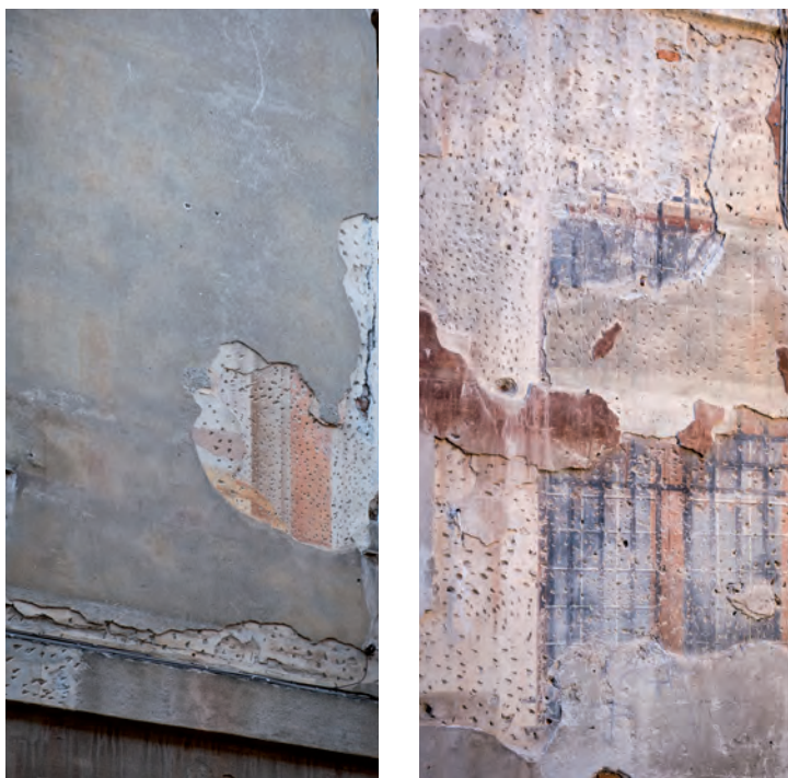
Fig. 200 - Particolari della facciata su via Roma. A sinistra, particolare di una mancanza nello strato di intonaco di epoca più recente. A destra, particolare della decorazione della facciata visibile attraverso le mancanze
