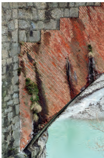
Fig. 226 - Esempi di fenomeni di alterazione e degrado: vegetazione infestante e incrostazioni carbonatiche
