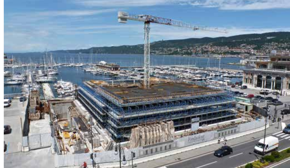
Esecuzione dei solai di calcestruzzo armato Execution of the reinforced concrete floors
