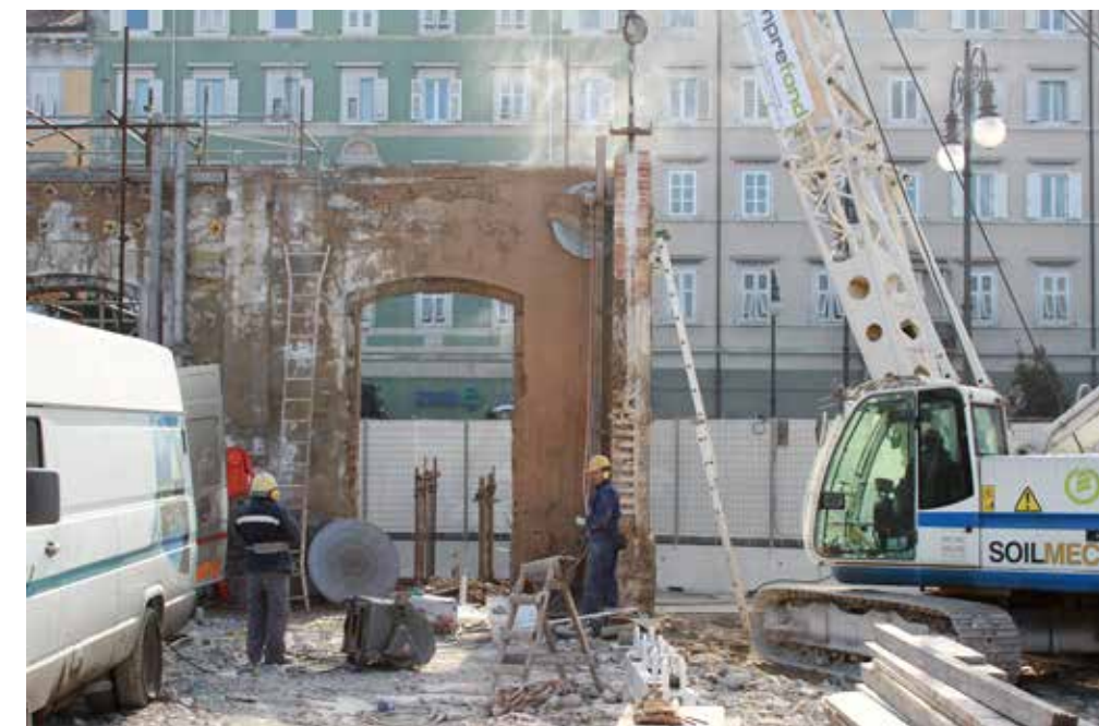
Taglio del primo maschio murario: dettaglio della lama movimentata su binari metallici Cut of the first wall block: detail of the blade moving on metal tracks
